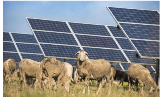
Schafherde grasst unter einer Freiflächen-Photovoltaikanlage..
