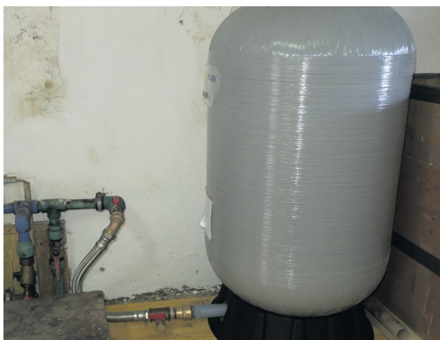
Ein typischer Membrankessel mit einer einzigen Anschlussleitung.
