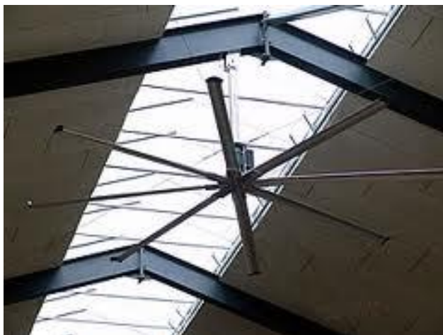
Abb.8: Deckenventilatoren sind nicht zur Vermeidung von Hitzestress geeignet. (Bild Quelle: www.stalldec.de )
