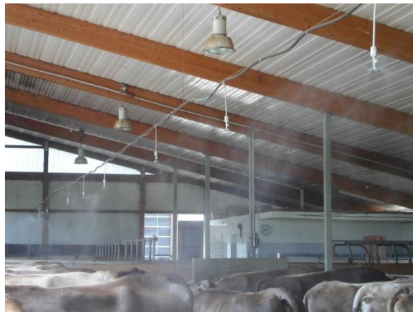
Abb.9: Kuhduschen erhöhen die Luftfeuchtigkeit im Stall.
