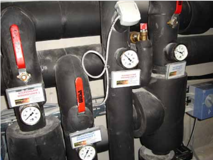
Durch gute Dämmung der Leitungen und Armaturen können Wärmepumpen eine hohe Energieeffizienz erzielen.
